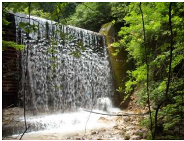
砂防ダム下のドラム缶取水口
